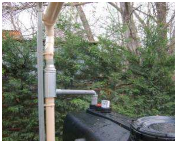
Détail du système de récupération d'eau
